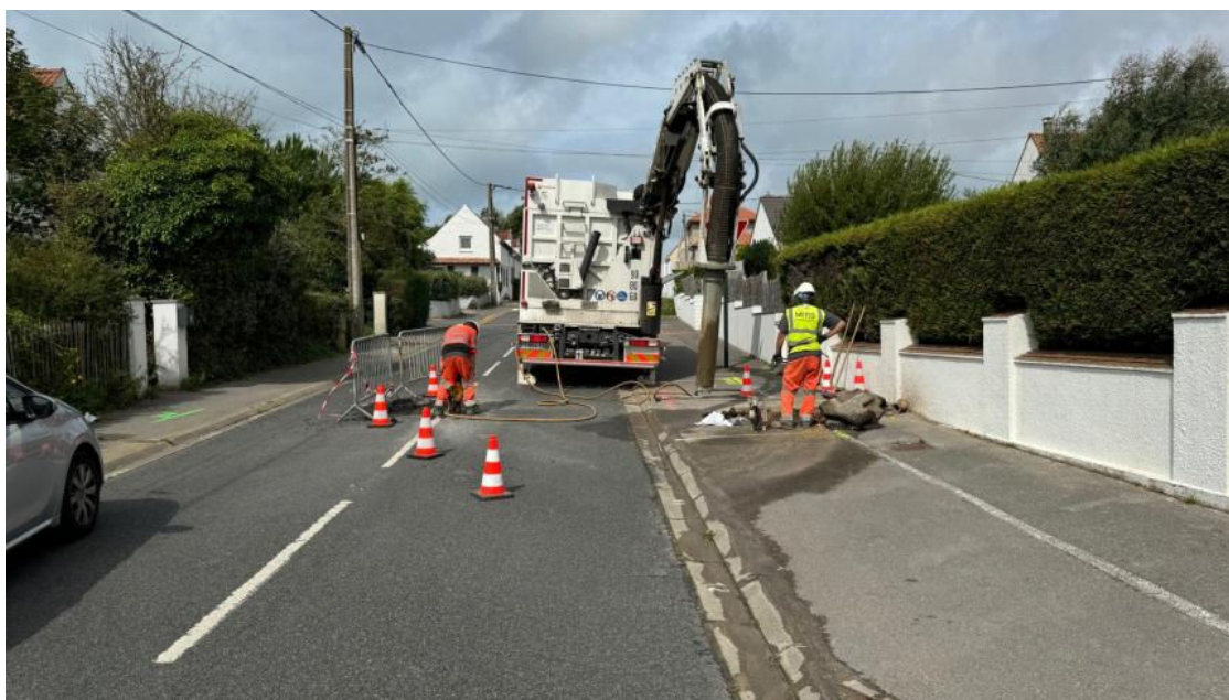
La fuite d'eau rue d'Aubengue à Slack a été rapidement circonscrite par les techniciens de Veolia.
