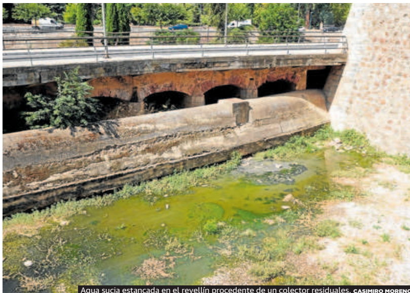
Agua sucia estancada en el revellín procedente de un colector residuales. CASIMIRO MORENO
